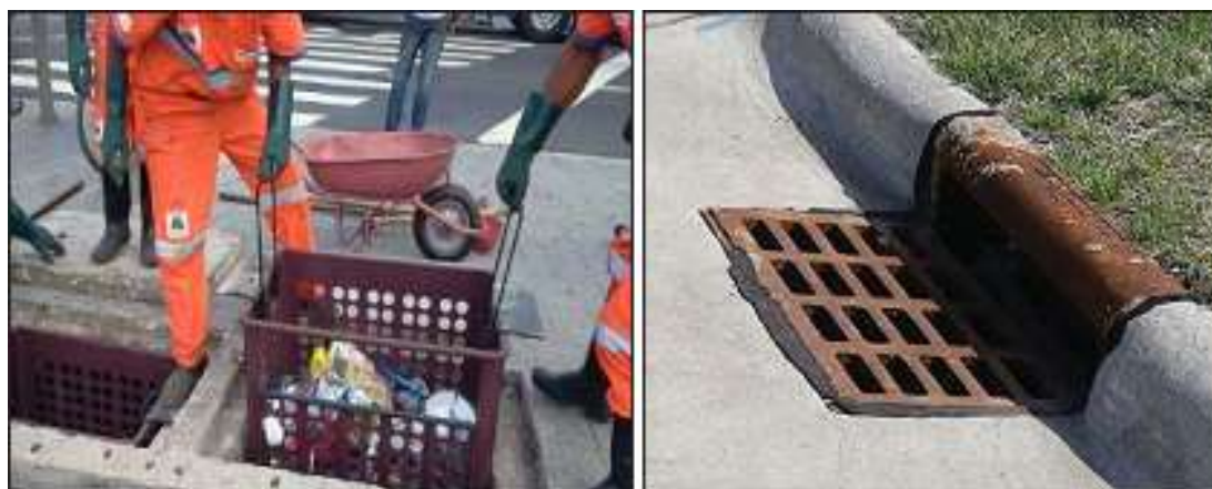
Figura 86: Cesta acoplada à boca do bueiro (Esquerda) e Boca de lobo com gradeamento na sarjeta (Direita)
