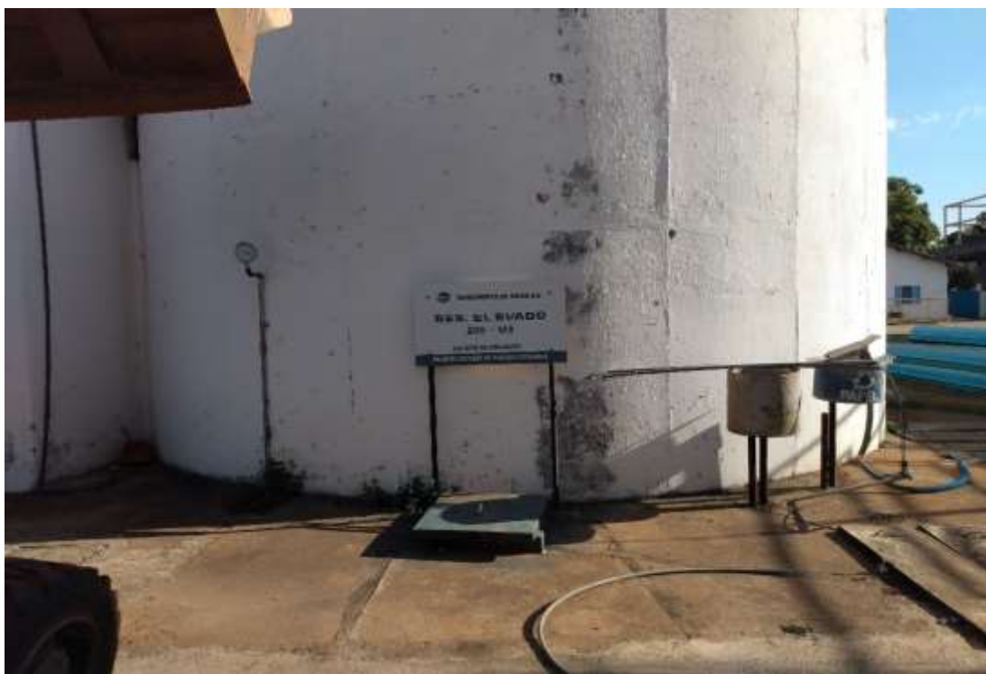
Figura 42: Reservatório Elevado da ETA (Capacidade de 200 m 3 )
