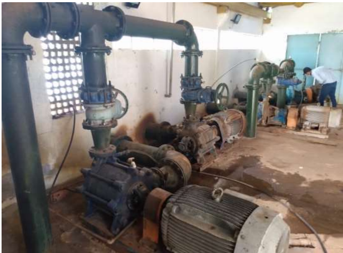
Figura 31: Estação Elevatória de Água Bruta (EEAB)
