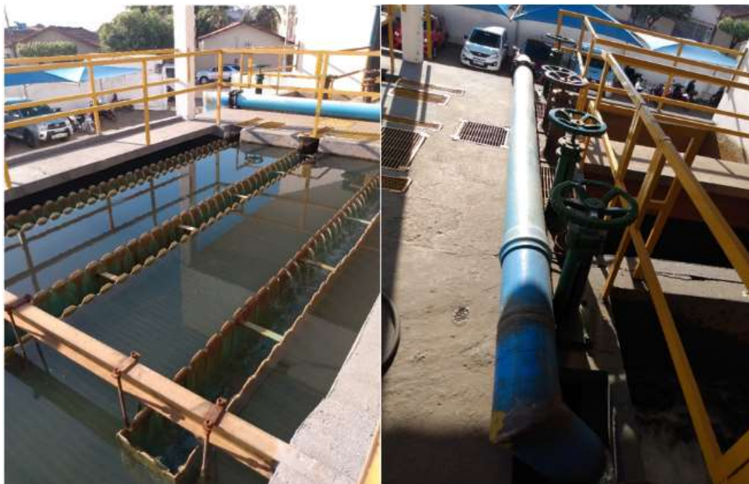
Figura 36: Decantador e Filtros
