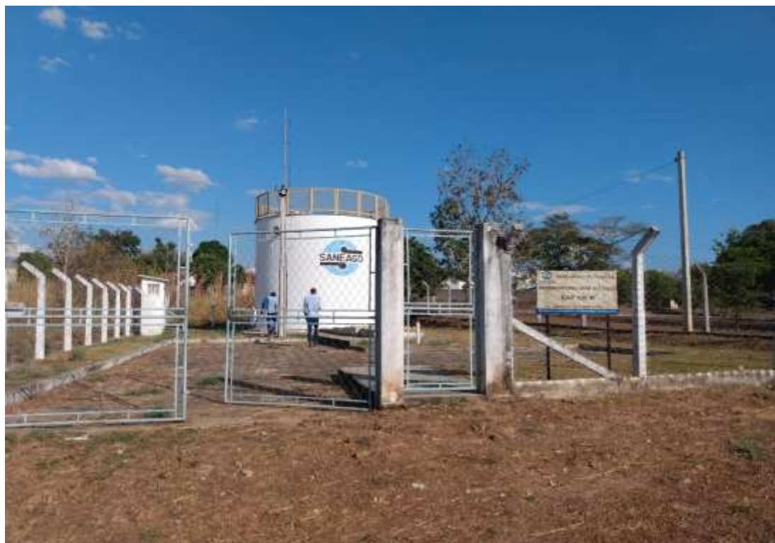
Figura 47: C.R. Bom Sucesso (Res. apoiado de 100 m 3 )
