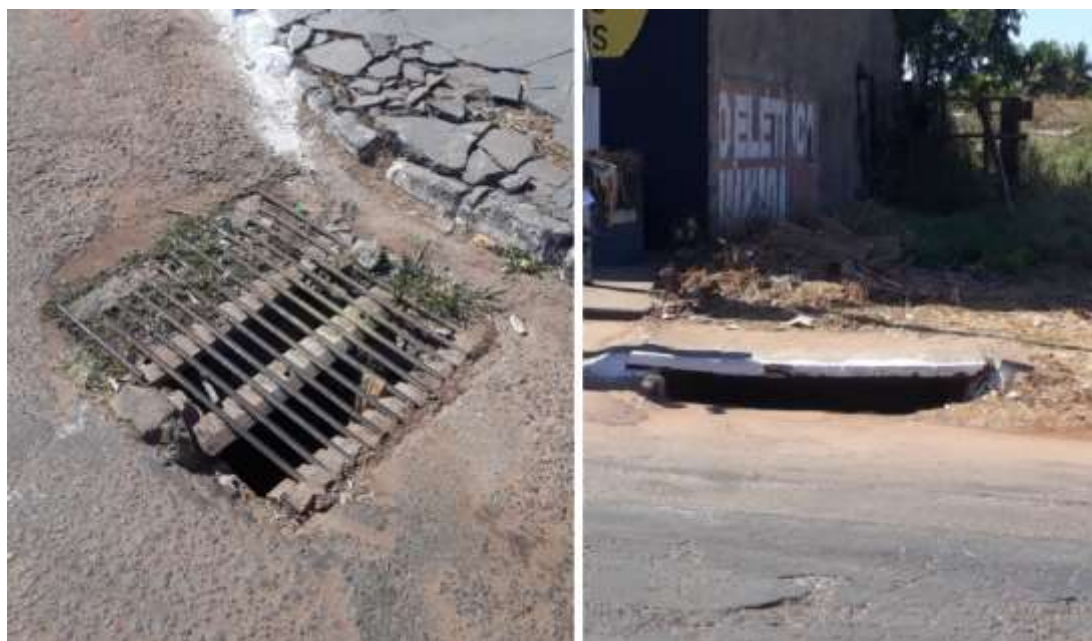
Figura 66: Dispositivos de drenagem pluvial urbana na Av. Federal (Esquerda) e Av. Adelino Américo de Azevedo (Direita) (Fonte: DOMANI ENGENHARIA E OBRAS, 2021)
