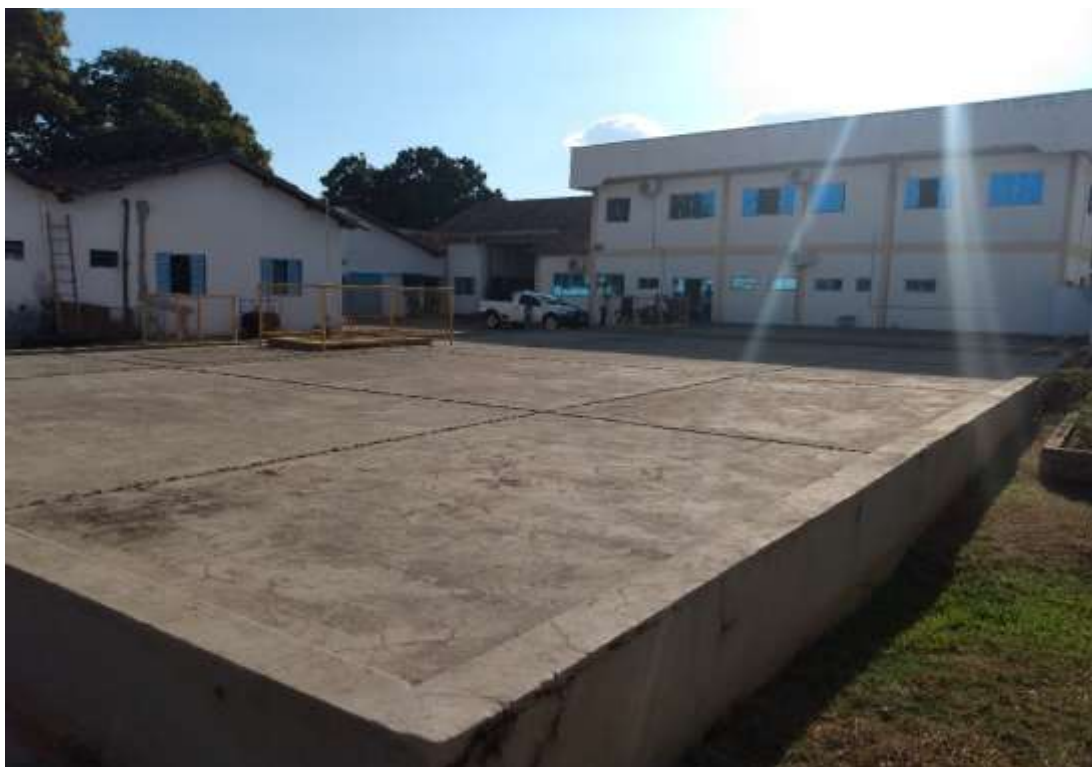
Figura 43: Tanque de Contato da ETA (Capacidade de 1.200 m 3 )
