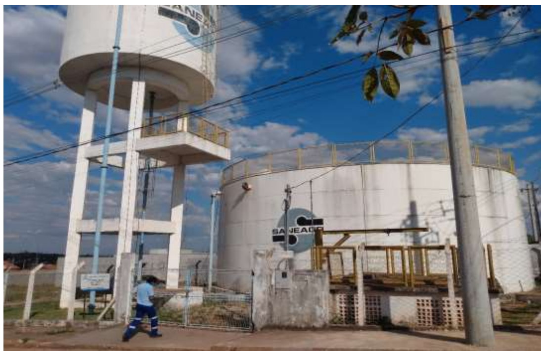
Figura 45: C.R. Cidade Jardim (Res. apoiado de 1.200 m 3 e Res. elevado de 200 m 3 ) (Fonte: DOMANI ENGENHARIA E OBRAS®, Set/2021)
