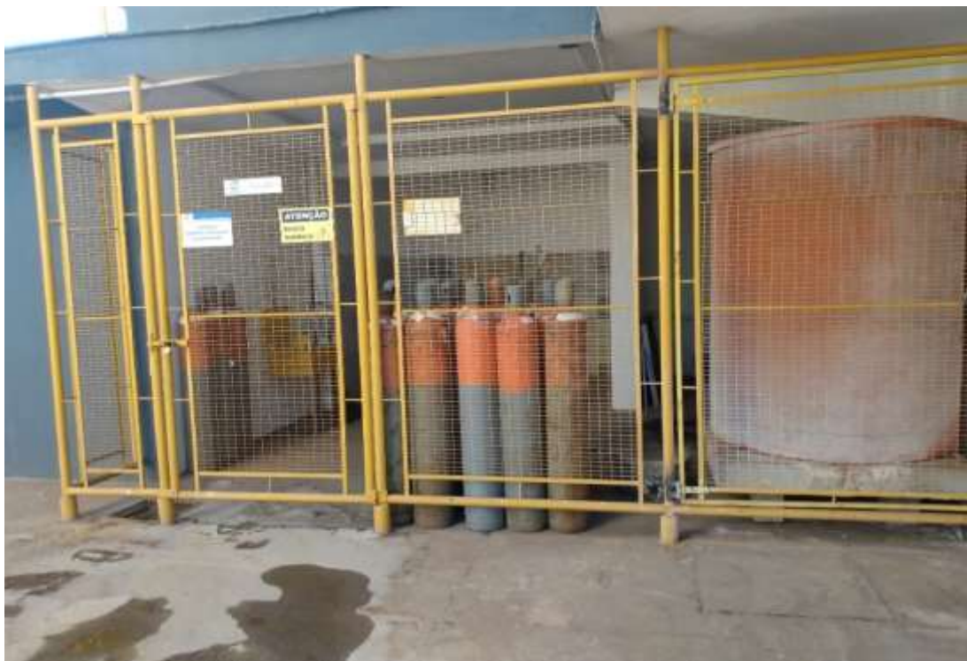
Figura 37: Sistema de dosagem de cloro e produtos químicos
