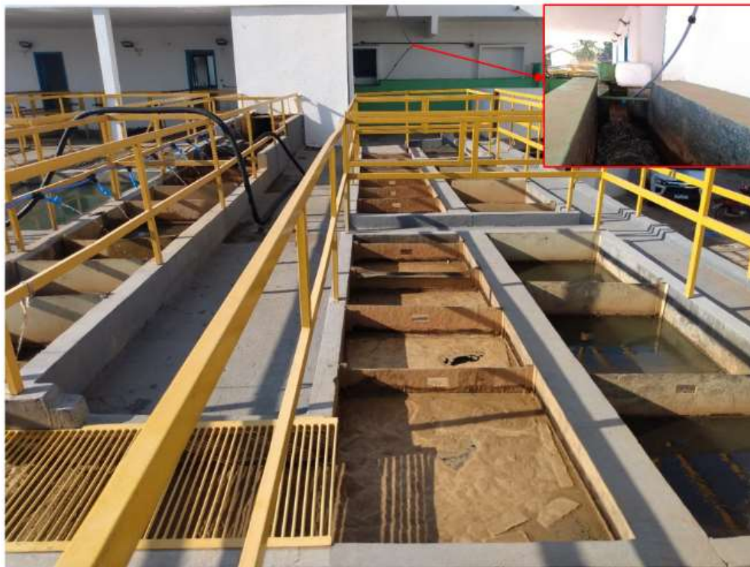
Figura 35: Processo de floculação na ETA
