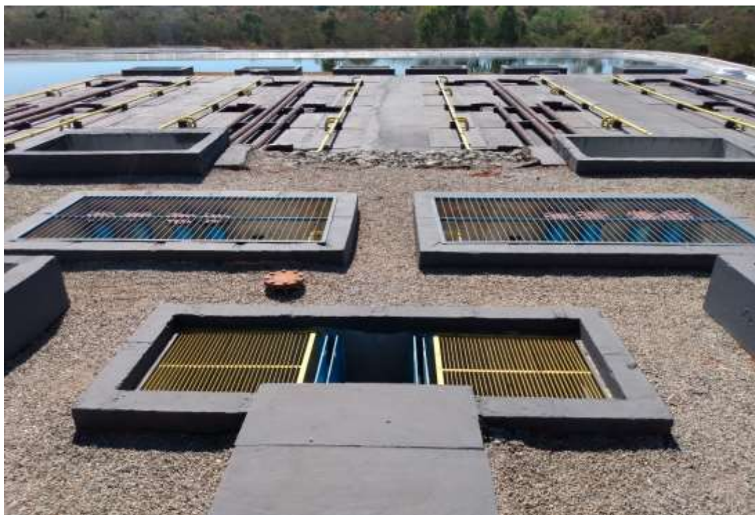
Figura 61: Estação de Tratamento de Esgoto (Reatores) (Fonte: DOMANI ENGENHARIA E OBRAS®, Set/2021)
