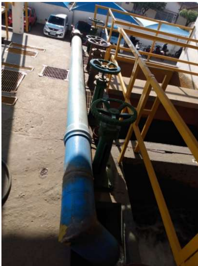
Figura 34: Chegada da água proveniente do Sistema Independente de Poços diretamente no filtro da ETA
