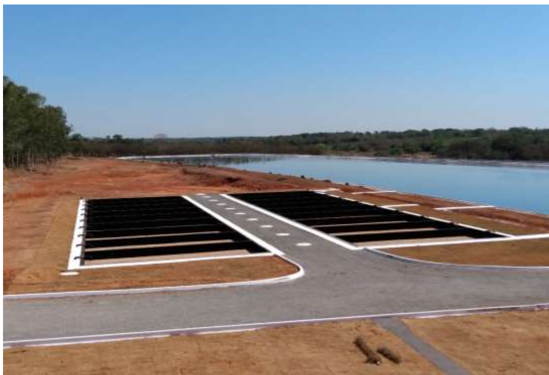
Figura 62: Estação de Tratamento de Esgoto (Leitos de Secagem) (Fonte: DOMANI ENGENHARIA E OBRAS®, Set/2021)
