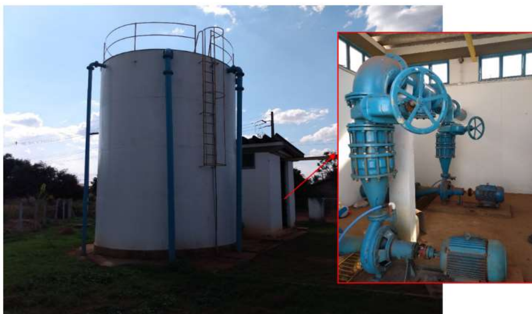
Figura 33: Caixa de Reunião dos Poços e respectiva Estação Elevatória de Água Bruta (Fonte: DOMANI ENGENHARIA E OBRAS®, Set/2021)
