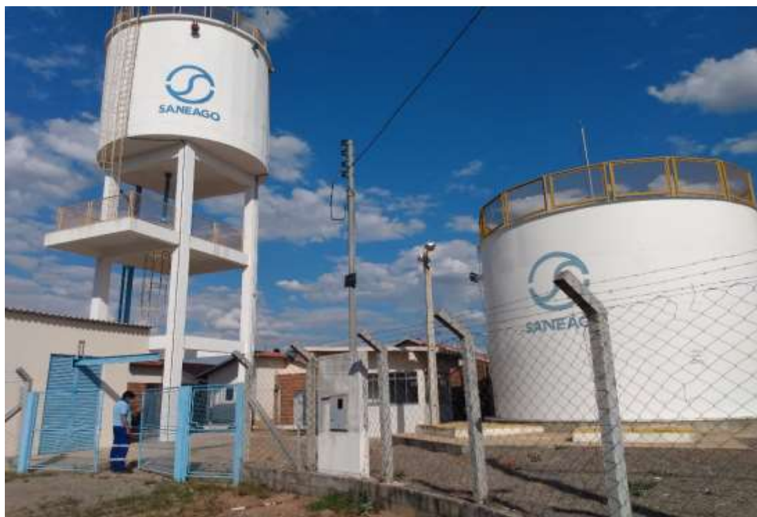
Figura 46: C.R. Amazonas (Res. apoiado de 150 m 3 e Res. elevado de 150 m 3 )
