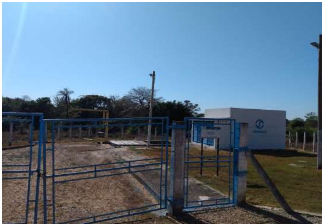
Figura 55: Estação Elevatória de Esgoto Lago (EEE Lago) (Fonte: DOMANI ENGENHARIA E OBRAS®, Set/2021)
