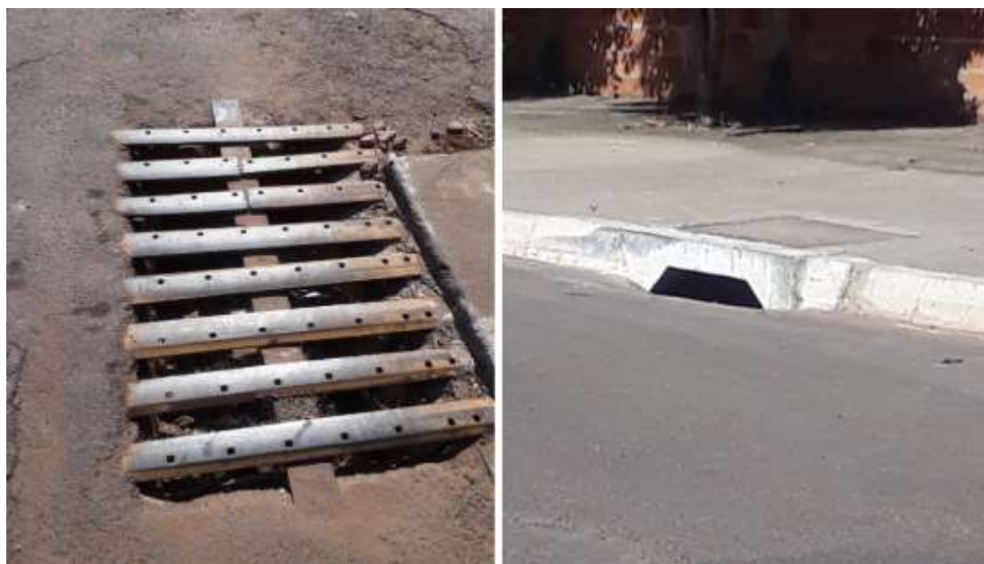
Figura 65: Dispositivos de drenagem pluvial urbana na Av. Federal (Esquerda) e Av. Goiás (Direita) (Fonte: DOMANI ENGENHARIA E OBRAS, 2021)
